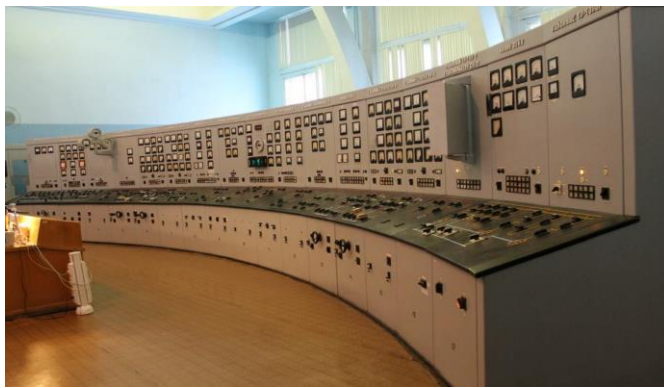
Рис. 4. Щит управления электростанции
